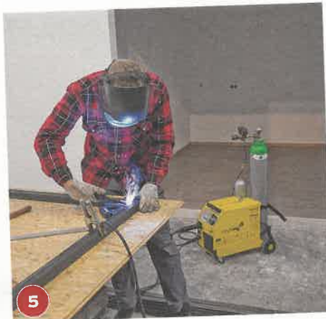
5 An der ersten Ecke die beiden Vierkantrohre mit zwei Schweißpunkten an den Eckstößen aneinanderheften.
